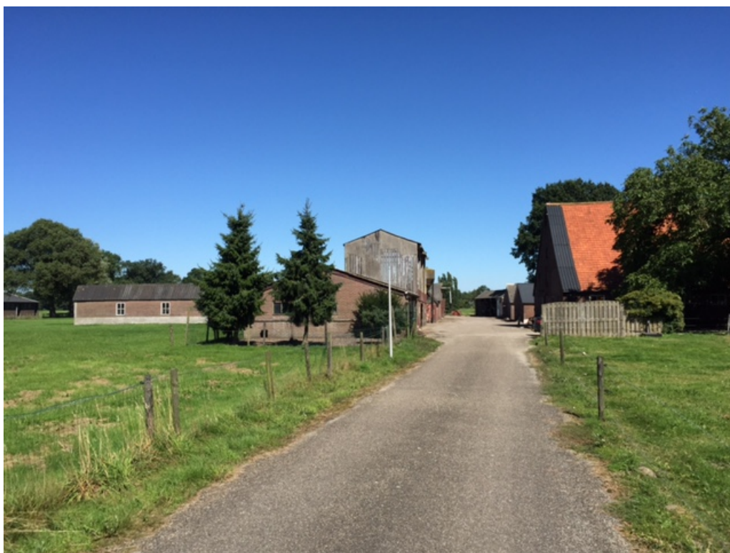
Figuur 2 De stallen en/of schuren verkeren in een bouwvallige staat. Het terrein tussen de bebouwing is verhard met asfalt en beton.
