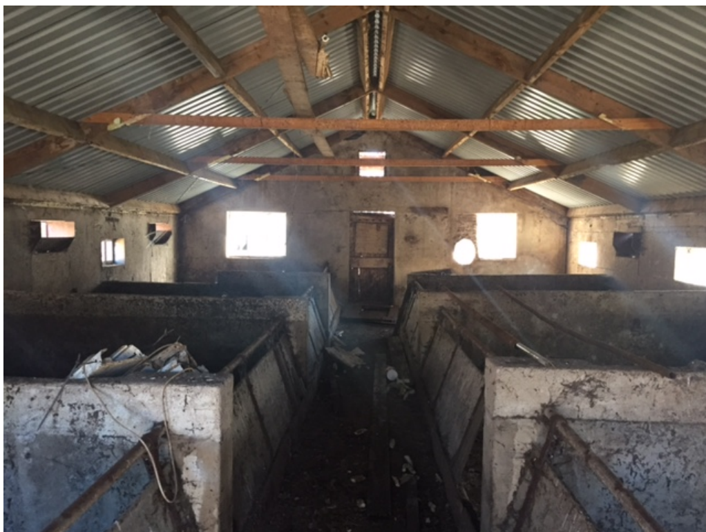
Figuur 4 De schuren verkeren in een deplorabele staat van onderhoud.
