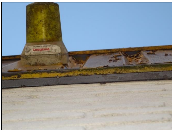
Figuur 10. Geen ruimte achter metalen dakrandafwerking bij oostelijk gelegen aanbouw.
