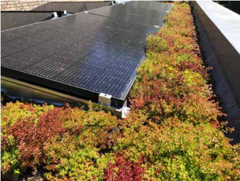
sedum dak met zonnepanelen
