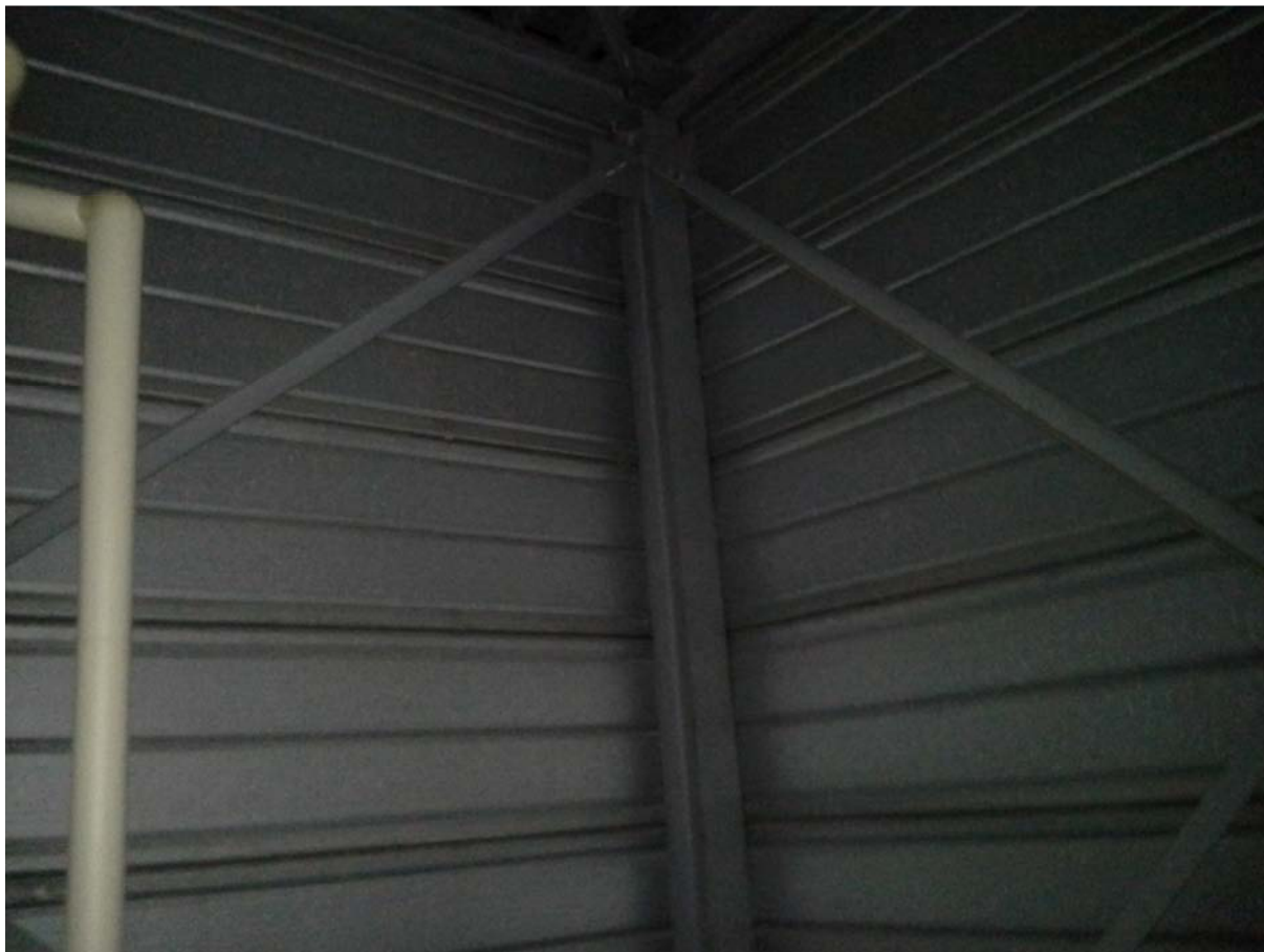
Foto 7: binnenzijde technische ruimte
