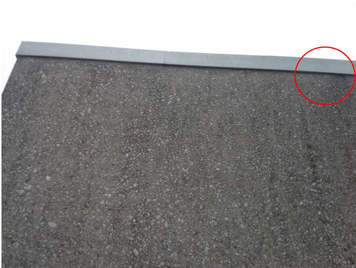
Foto 29: verdachte plek gevel
