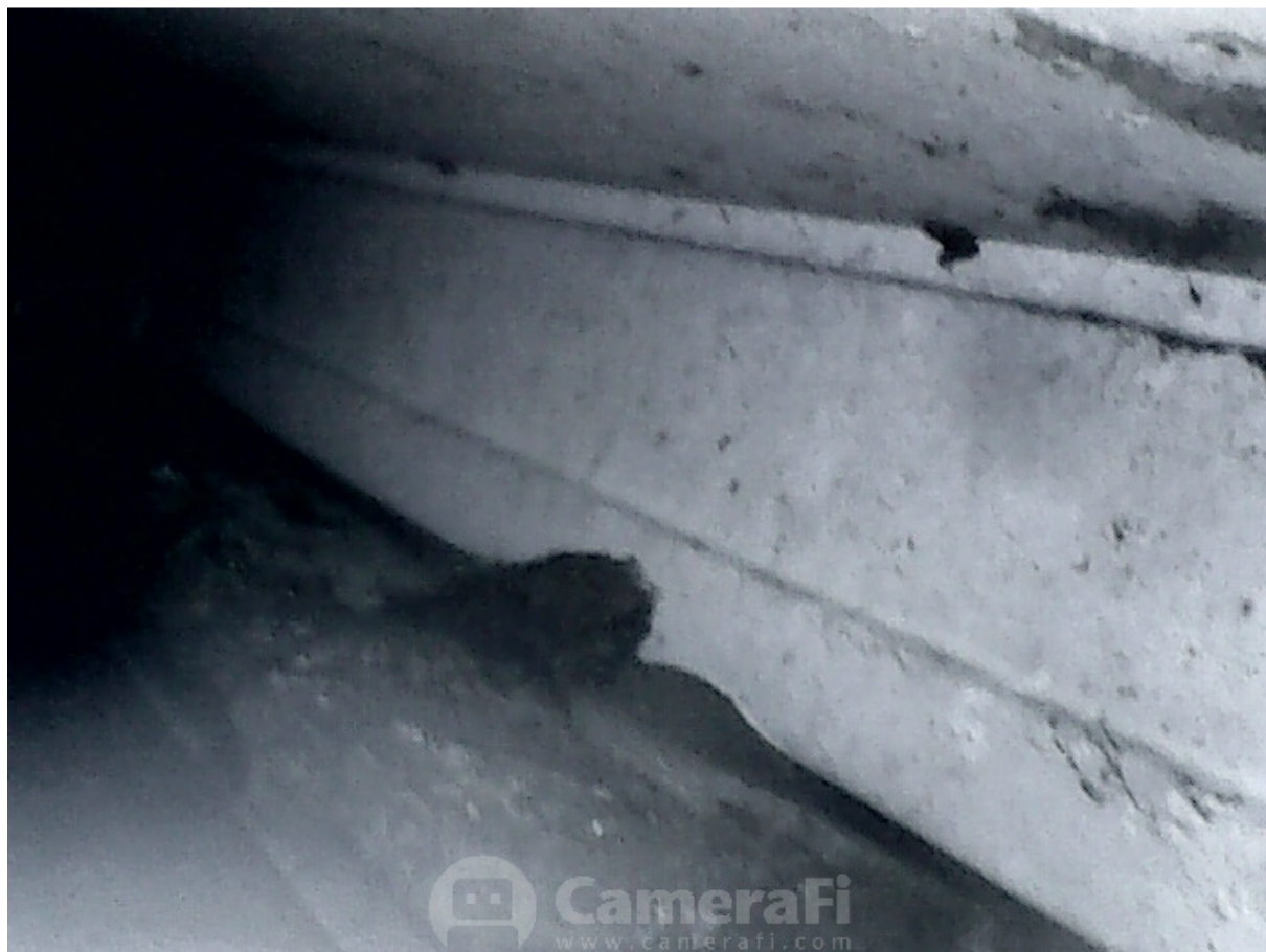
Foto 15: kier kozijn uitbouw
