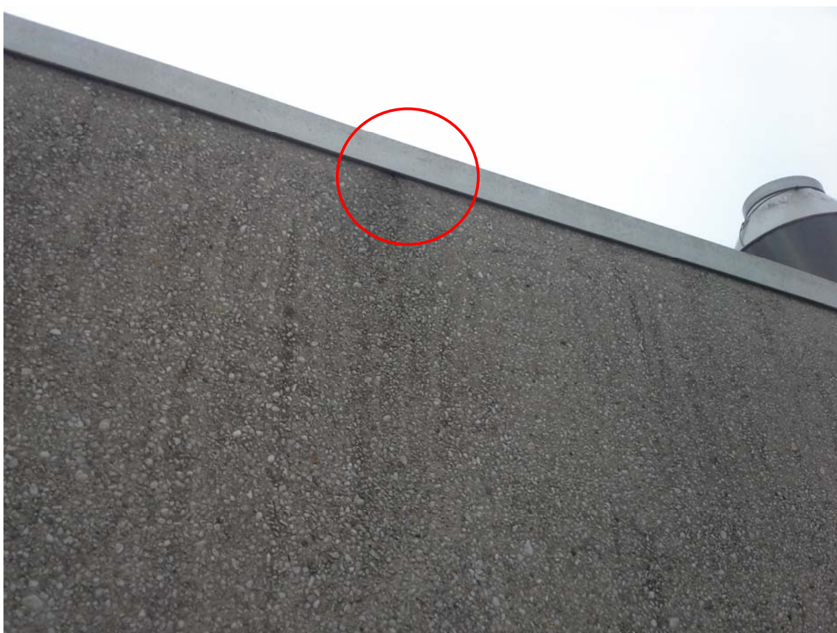
Foto 28: verdachte plek gevel
