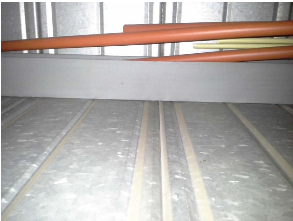
Foto 6: binnenzijde technische ruimte
