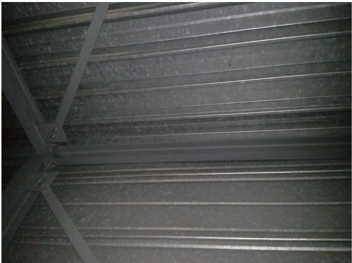
Foto 4: binnenzijde technische ruimte
