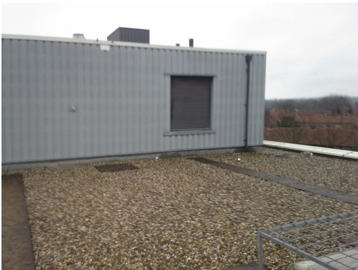
foto 26: technische ruimte buitenzijde
