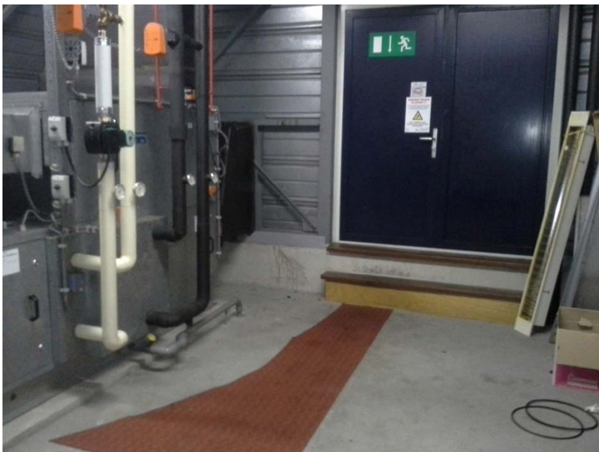
Foto 8: binnenzijde technische ruimte
