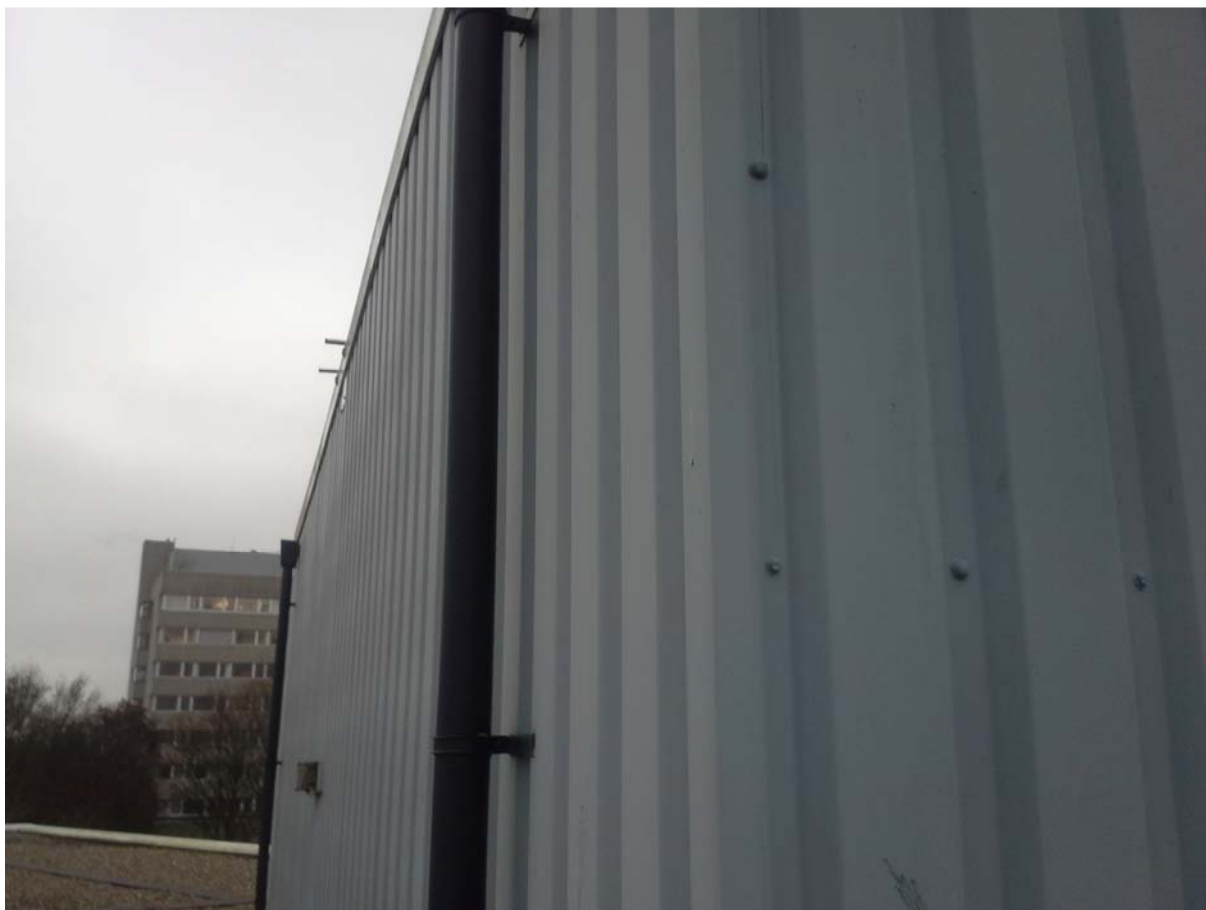
foto 25: technische ruimte buitenzijde
