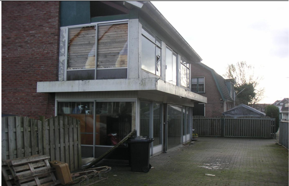
Figuur 3. Het pand is vooral aan de voorzijde in slechte staat.
