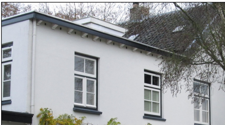
Figuur 12. Openingen in de muur onder de dakrand aan de Pinkenbergseweg.
