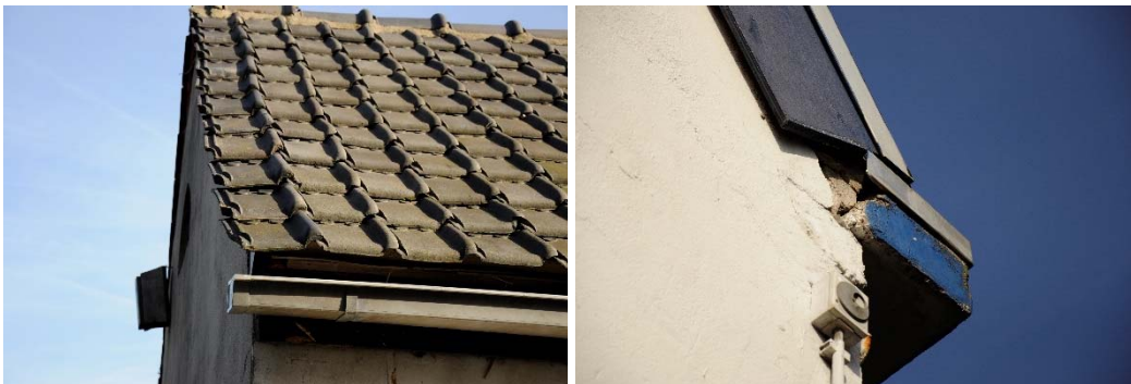
Afbeelding 3. De slechte staat van de panden faciliteren vleermuizen ze te gebruiken. De kieren en scheuren maken het de soorten mogelijk in een ruimte van de gebouwen weg te kruipen.
