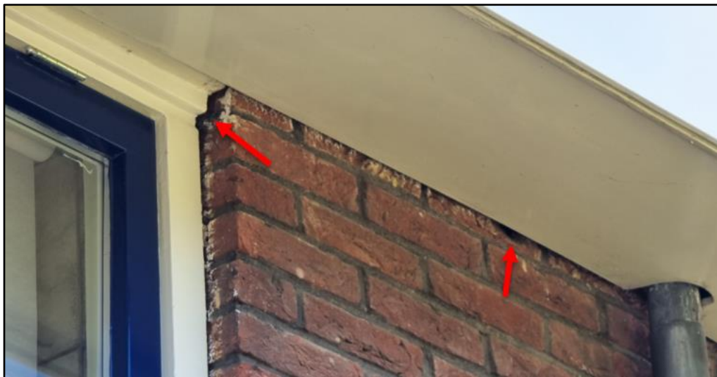
Figuur 4 Plaatsen waar de gootconstructie en kozijnen niet nauwsluitend zijn op de gevel.
