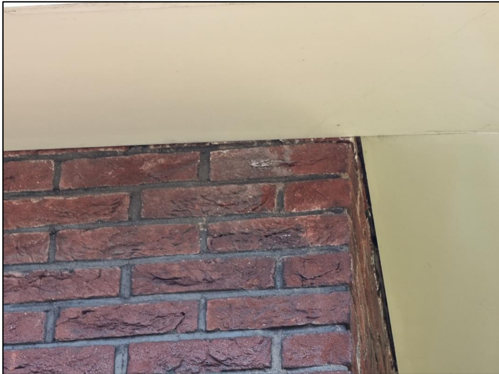
Figuur 3 De gootconstructie van het dak sluit niet nauw aan op de gevel waardoor vleermuizen toegang tot achterliggende ruimte kunnen vinden.
