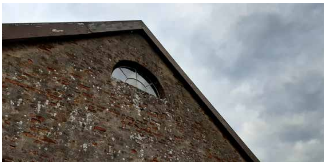
De te slopen schuur.
