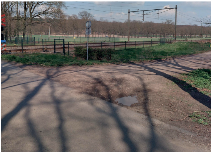
3.4 Huidige aansluiting niet bestand tegen draaiend verkeer
