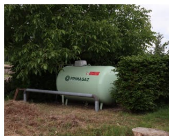
Omhaagde gastank op het achtererf.
