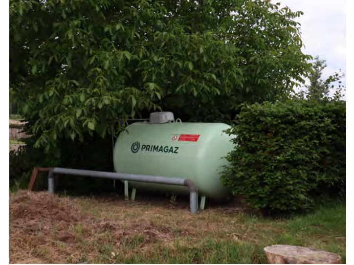
Omhaagde gastank op het achtererf.
