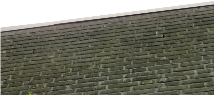
Afbeelding 31: Open stootvoegen in gevel bij entree
