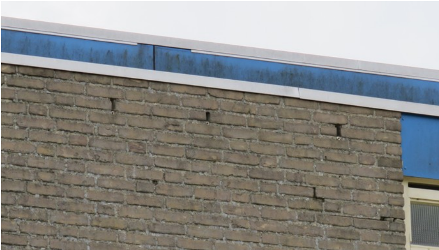
Afbeelding 25: Open stootvoegen in bakstenen geveldeel gebouw A.
