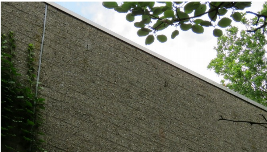
Afbeelding 20: Open stootvoegen in noordwest gevel gebouw A
