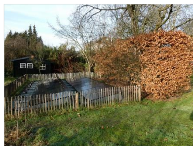
Figuur 2.5 Zonnepanelen met daarachter een schuur.
