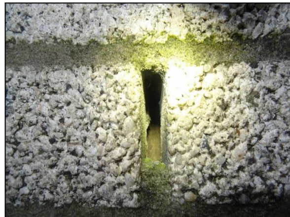
Figuur 15. Open stootvoegen met daarachter een open spouw.
