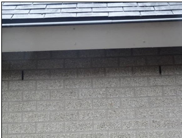
Figuur 14. Open stootvoegen rond de bebouwing die toegang geven tot de spouw.
