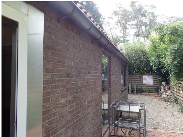
Foto 2: rechts, uitwerpselen van vleermuizen op vensterbank westzijde
