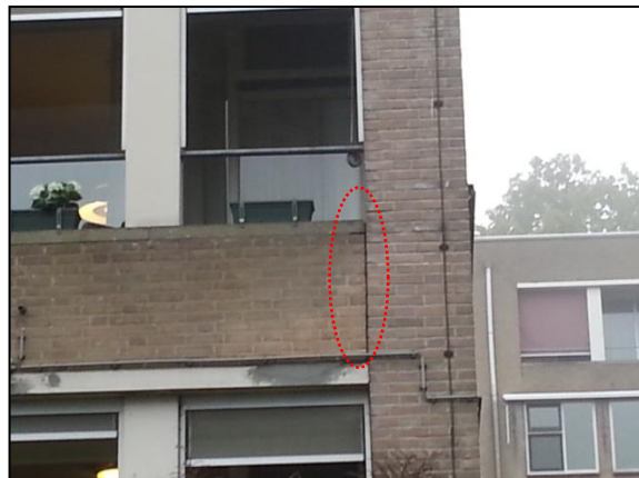
Figuur 13. Muurspleet zuidzijde bebouwing.
