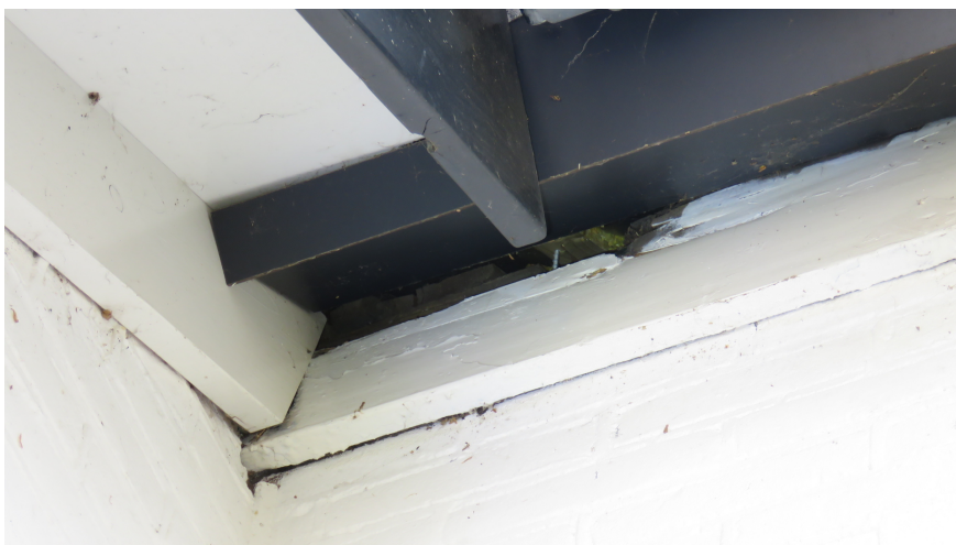
Afbeelding 12: Openingen bij de dakrandconstructie van de bedrijfswoning
