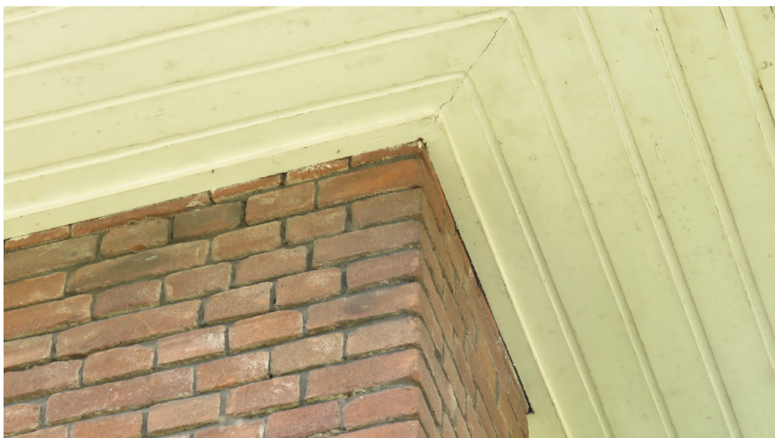
Afbeelding 10: Het dakoverstek van het woonhuis sluit zeer nauw, langs het grootste deel van de gevel zijn er geen/te kleine kieren voor vleermuizen. Open stootvoegen zijn niet aanwezig in de muur.
