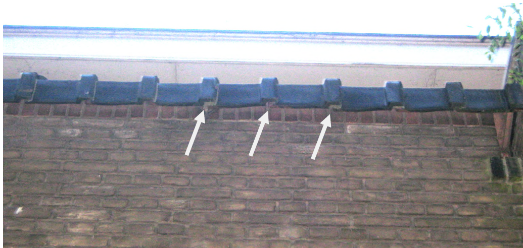
Foto 1. Bovenrand muur (zijde noordelijke binnentuin) van de kapel in de binnentuin van klooster Mariënbosch; de pijlen geven de invliegopeningen aan die gewone dwergvleermuizen gebruiken om de zomerverblijfplaats te bereiken.
