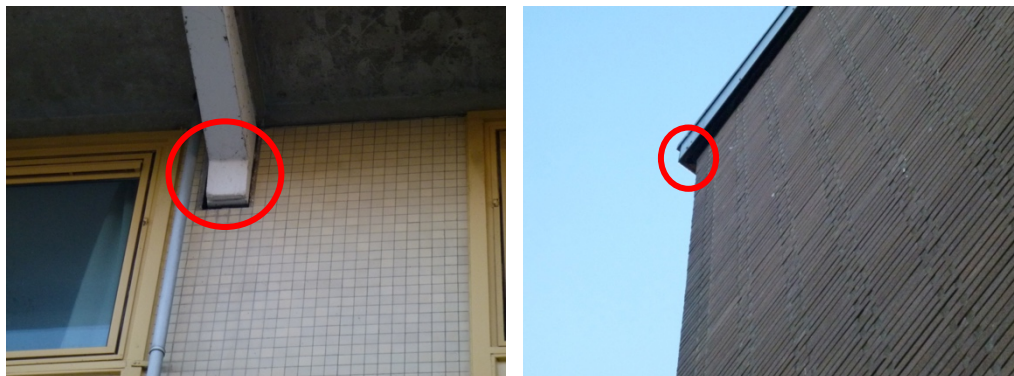
De kieren bij de betonnen dragers (links) en de kleine opening op de hoeken van kopgevels waar de boeiboorden niet goed op elkaar aansluiten (rechts).
