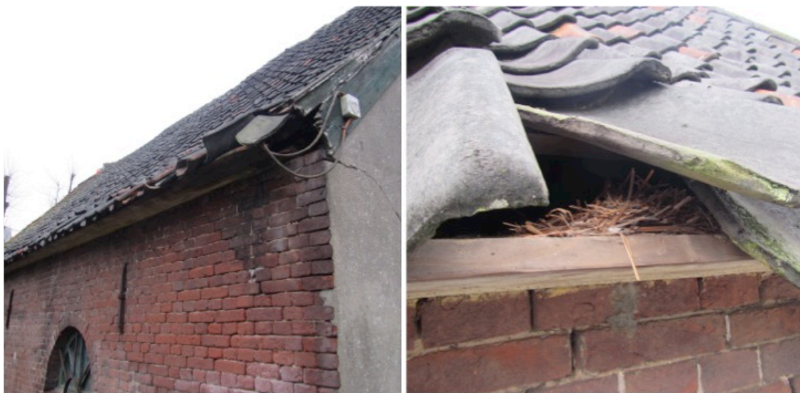
Figuur 3 Foto's dakconstructie met kieren en oud nestmateriaal
