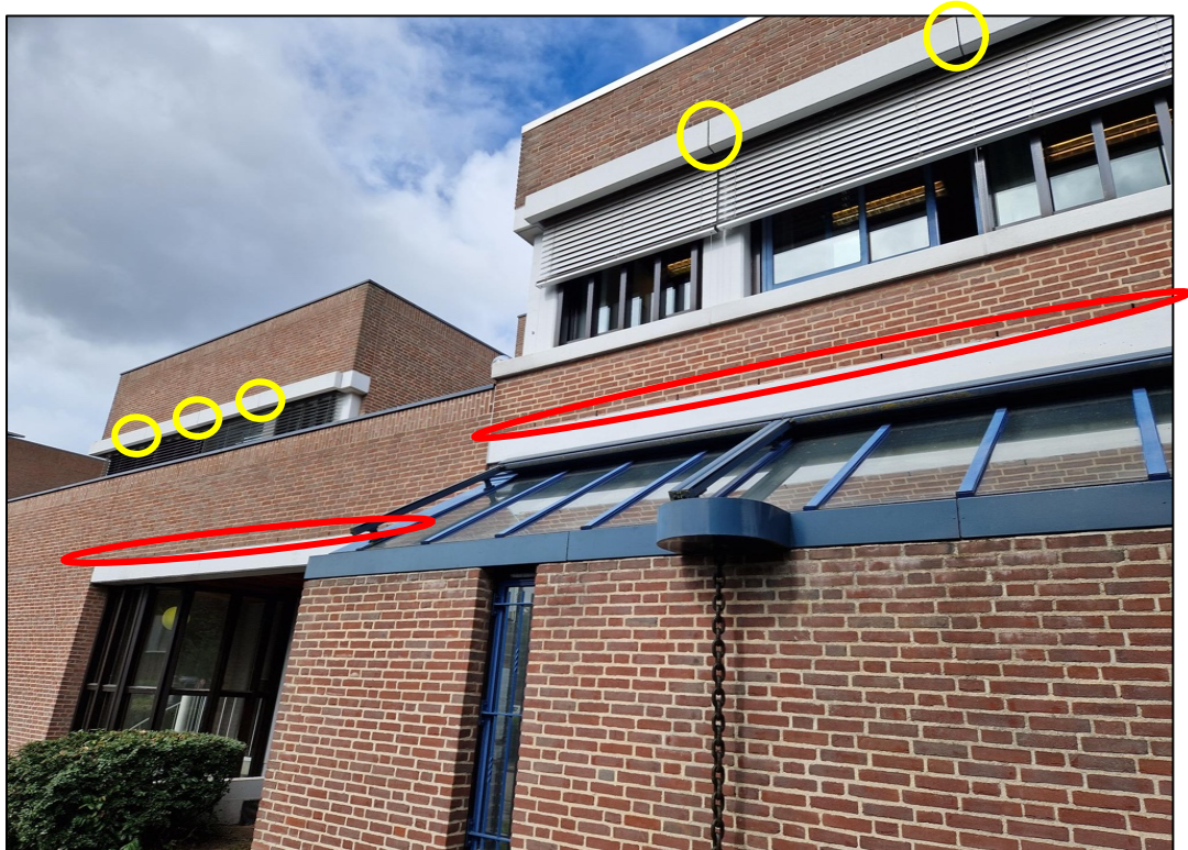
Figuur 4 Oostzijde bedrijfspand met openstootvoegen (binnen rood ovaal) en dilatatievoegen (gele cirkels).
