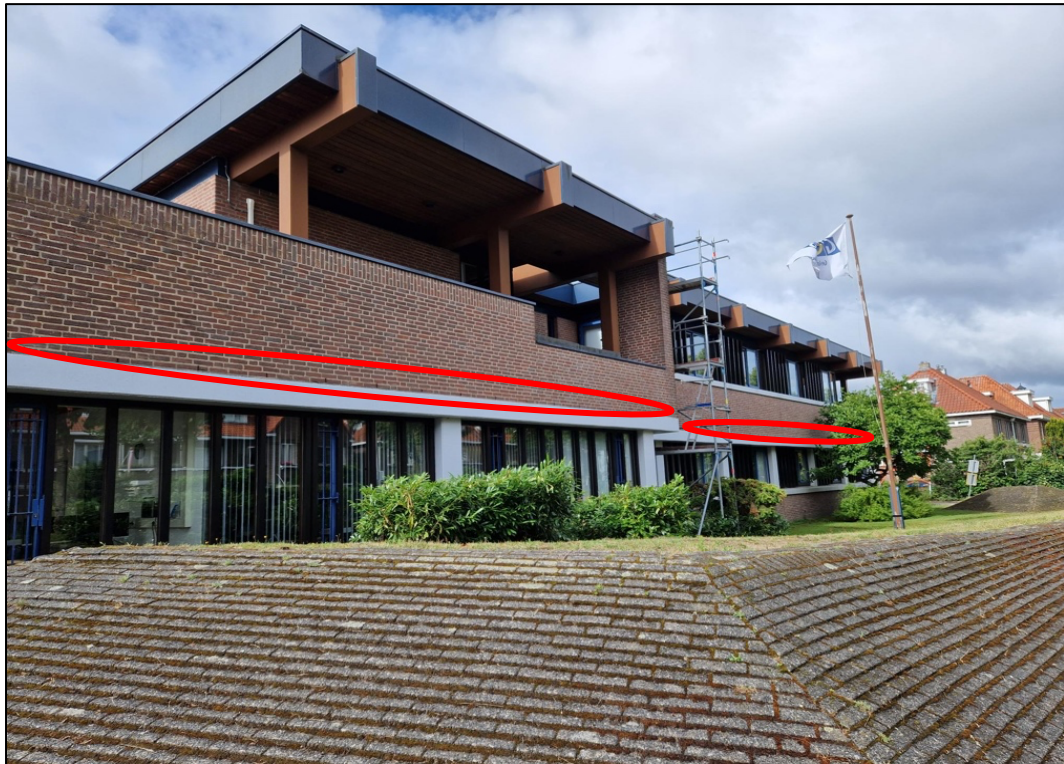
Figuur 2 Noordzijde (vooraanzicht) van het bedrijfsgebouw; open stootvoegen (binnen rode ovalen).
