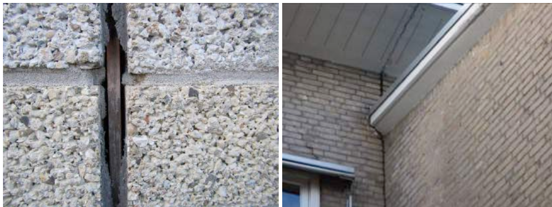
Figuur 6 Beschadigde dilatatievoeg en daklijst.
