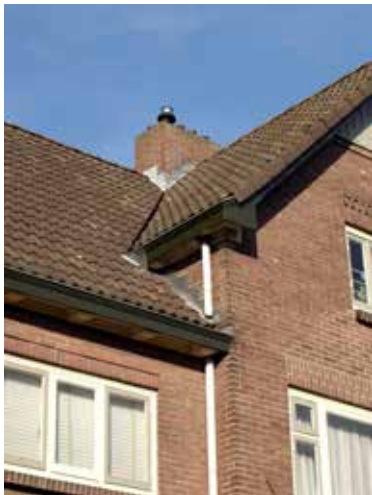
rooilijsprong t.p.v. kopgevel
