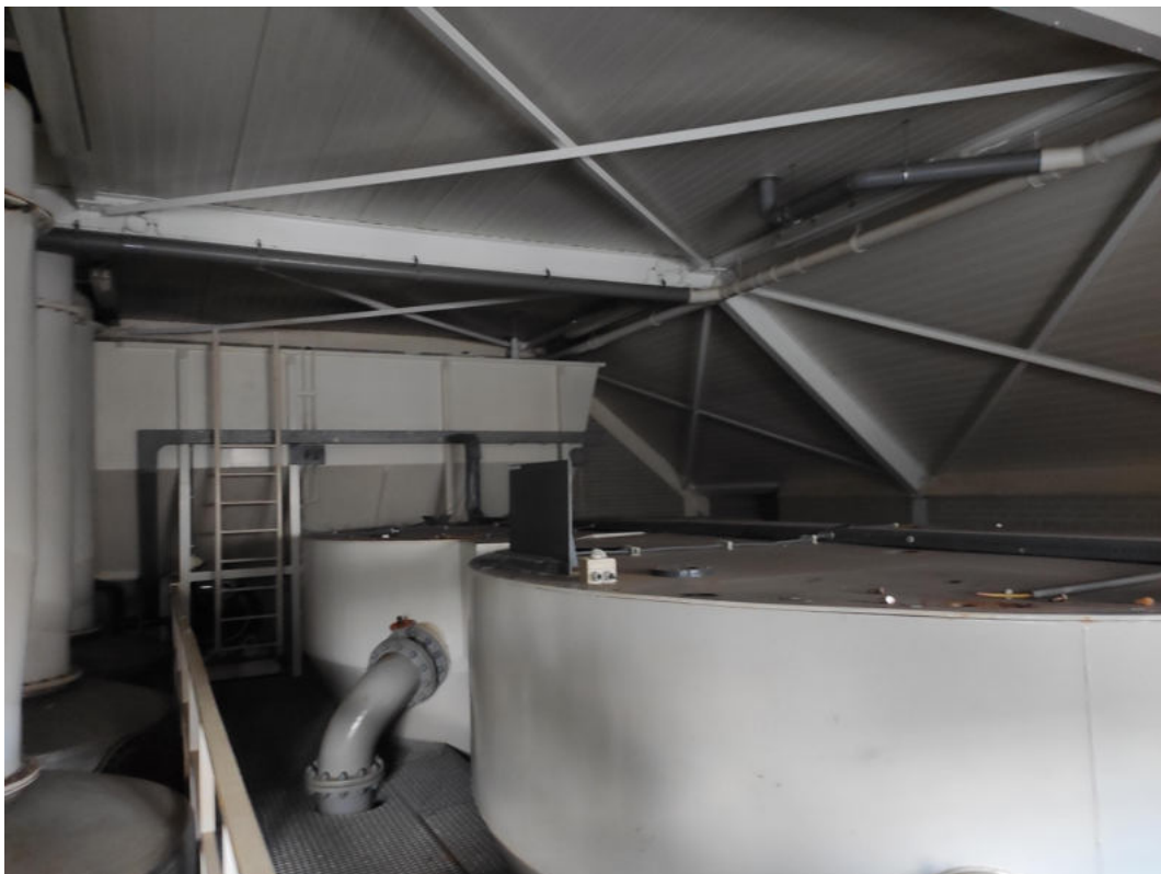
Figuur 3 Watertanks in het pompstation.
