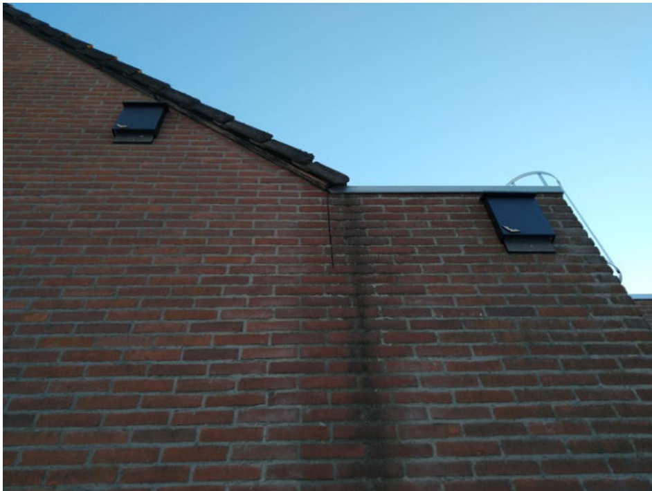
Twee kasten aan de portiekgevel van Crocusstraat 47.
