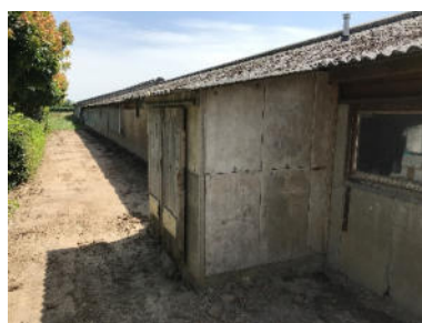
foto 7 - ter plaatse van asbestgat G5
