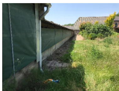
foto 8 - ter plaatse van asbestgat G8
