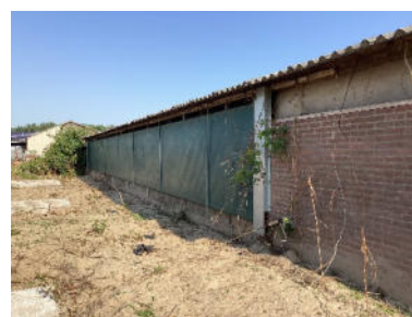
foto 9 - ter plaatse van asbestgat G11
