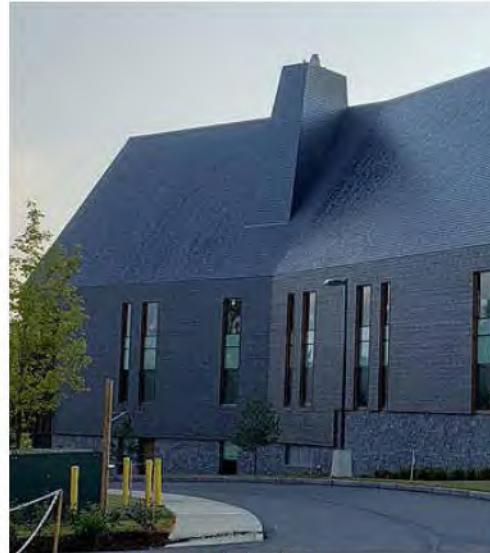
dak en gevel lopen door in elkaar
