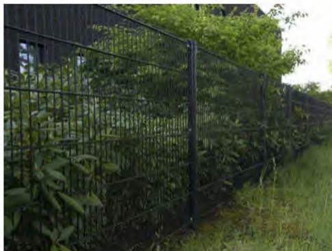
hekwerk tegen de groenbuffer
