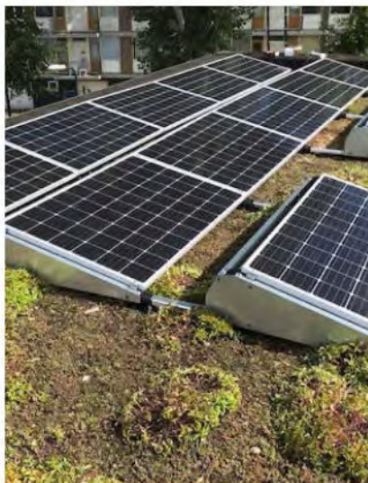
zonnepanelen i.c.m. sedumdak
