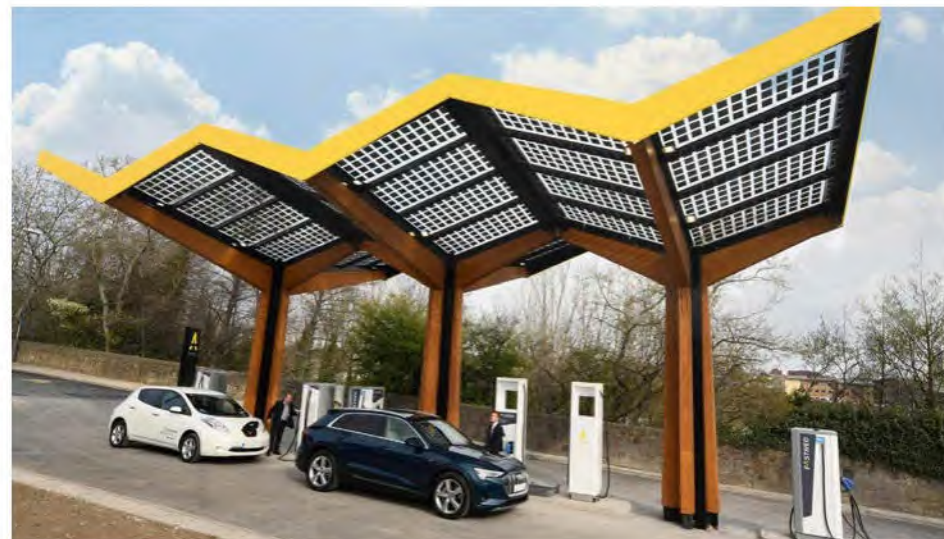
PV-panelen als bron voor opladen
