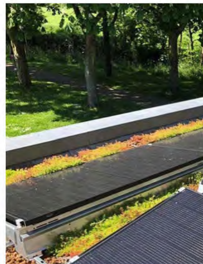
zonnepanelen i.c.m. sedumdak
