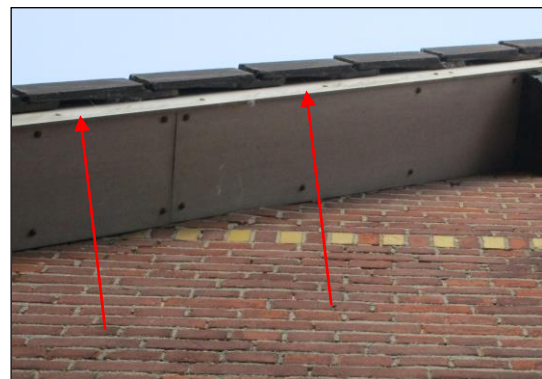
Foto 8: Ruimtes tussen de dakpannen geschikt voor vleermuizen
