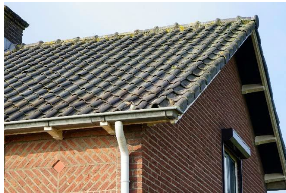
Close-up van het dak met aanwezige huismussen en losliggende dakpannen en gevelpannen.
