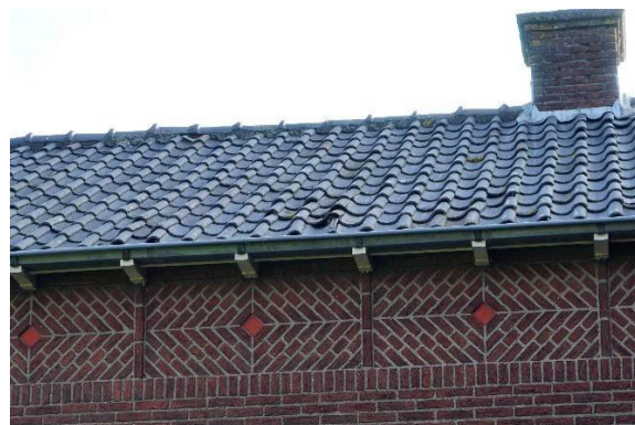
Close-up van het dak met losliggende dakpannen.
