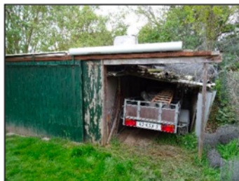
Figuur 6. Vervallen schuurtje in het noorden van de onderzoekslocatie.
