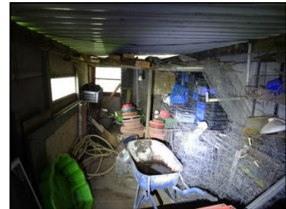
Figuur 11. Vervallen schuurtje op onderzoekslocatie.
