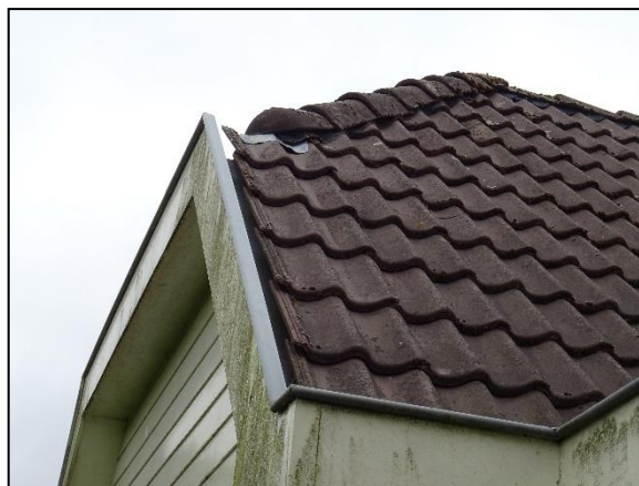
Figuur 13. Ruimte langs de dakpannen biedt toegang tot dakbeschoot, wat nestgelegenheid biedt aan huismussen.
