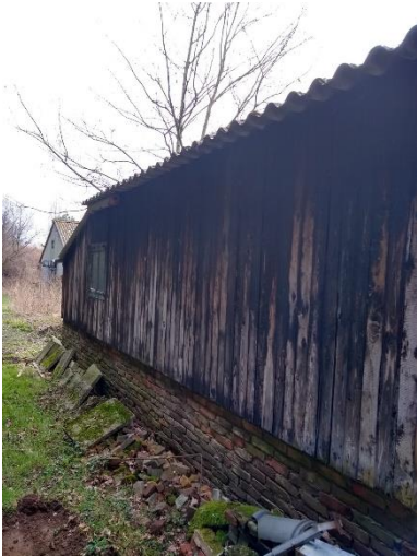
Foto 1: Dak zonder dakgoot (schuur 1)
