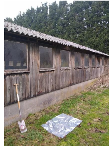
Foto 3: Dak zonder dakgoot (schuur 2)
