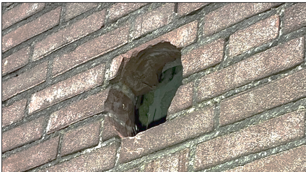
Figuur 3.4 De spouwmuur is met steenwol gevuld, hier zichtbaar in een gat boven in de gevel. Ook bij inspectie van de open stootvoegen is steenwol aangetroffen.
