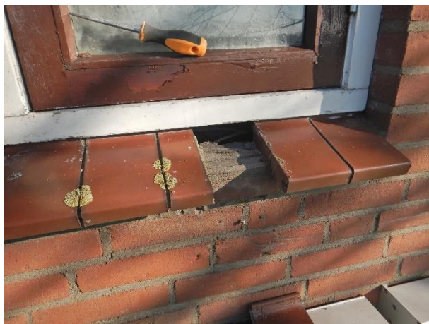
Geen verdachte waterkering in spouw
