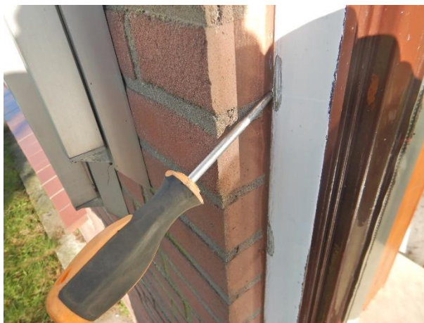
Geen verdachte waterkering in spouw
