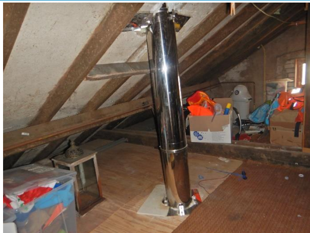
Rookgas afvoer openhaard, brandwerende plaat op vloer niet verdacht
