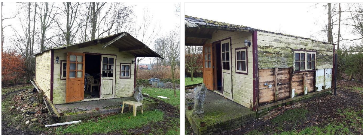
Afbeelding 5.1: Het in slechte staat verkerende tuinhuisje. Diverse planken zijn verdwenen en het dak is sterk aangetast door houtrot. Foto's: Natuurkompas, 2023.
