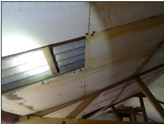
Fig. 2.16 Ontbrekende dupanelplaat gebouw nr. 4 (bron: FF Solutions)
