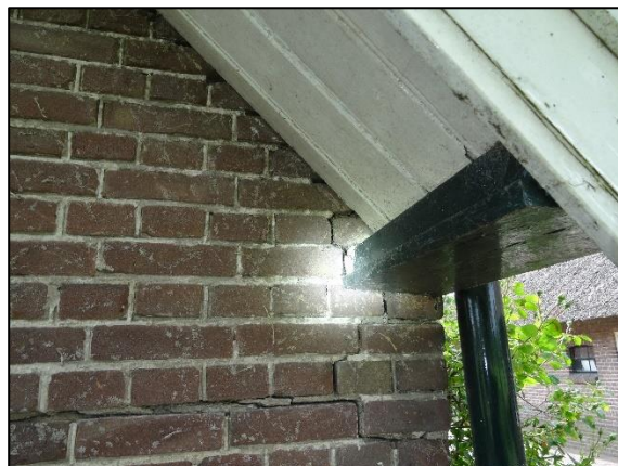
Fig. 2.20 Spleet in muur gebouw nr. 5 (bron: FF Solutions)
