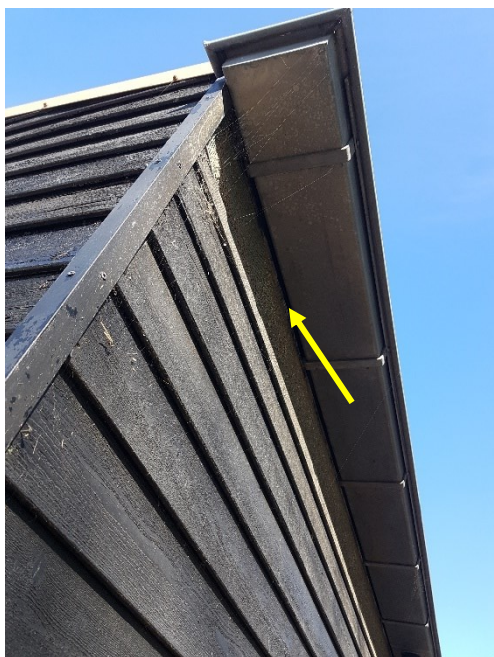
Figuur 6. Openingen onder de dakgoot die vleermuizen toegang kan bieden tot de schuur (gele pijl).
