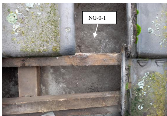
Foto 5: Asbesthoudend plaatmateriaal als plafond van een klein gedeelte in de woning. Van binnen niet zichtbaar i.v.m. aanwezigheid van verlaagde plafonds.
