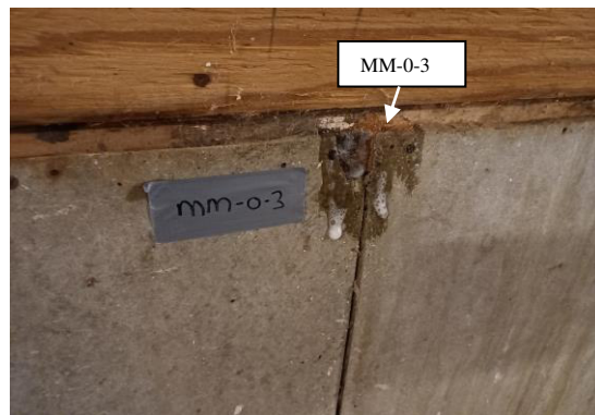
Foto 14: Asbesthoudend plaatmateriaal aan binnenwanden van schuur 4.
