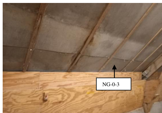
Foto 16: Asbesthoudend plaatmateriaal als dakbeschot/plafond van schuur 4.
