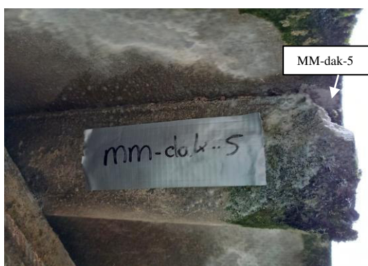
Foto 21: Asbesthoudende golfplaat als dakbedekking van schuur 5.
