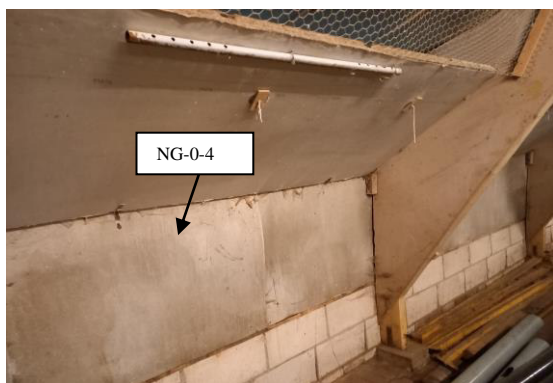
Foto 19: Asbesthoudend plaatmateriaal aan binnenwanden van schuur 5.
