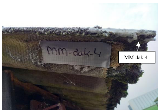
Foto 17: Asbesthoudende golfplaat als dakbedekking van schuur 4.
