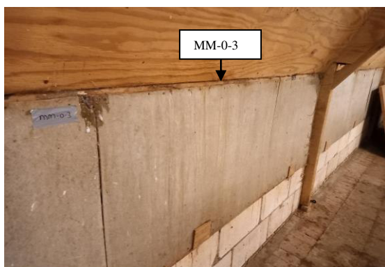
Foto 15: Asbesthoudend plaatmateriaal aan binnenwanden van schuur 4.
