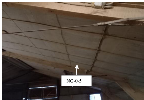
Foto 20: Asbesthoudend plaatmateriaal als dakbeschot/plafond van schuur 5.
