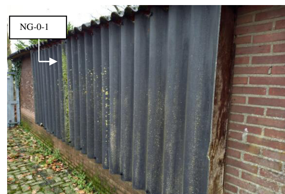
Foto 6: Asbesthoudende golfplaat als gevelplaat van van de schuur.
