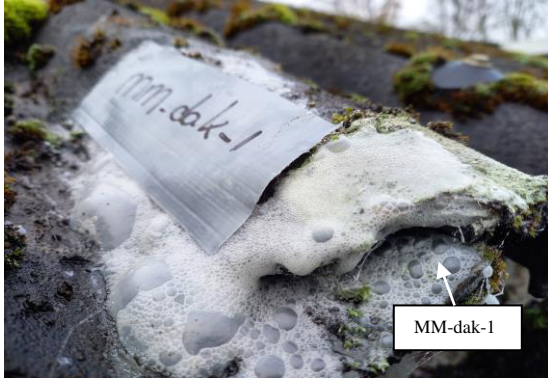
Foto 1: Asbesthoudende golfplaat als dakbedekking van de schuur.
