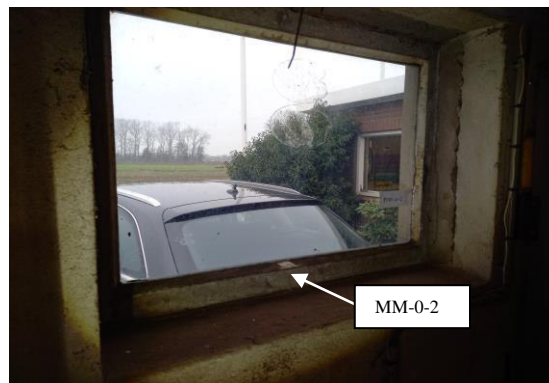
Foto 8: Asbesthoudende stopverf in/aan de raamkozijnen van de schuur.
