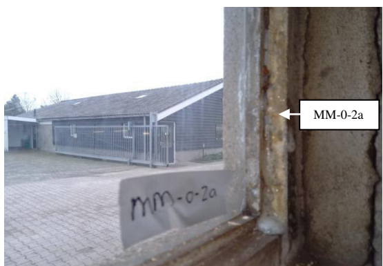
Foto 9: Asbesthoudende stopverf in/aan de raamkozijnen van de schuur. Dit monster was asbestvrij maar betreft identiek materiaal aan MM-0-2. Door de relatief lage concentraties asbest is dit niet altijd homogeen verdeeld aanwezig in de stopverf
