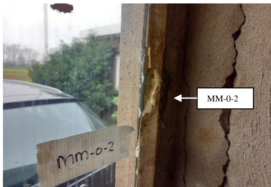
Foto 7: Asbesthoudende stopverf in/aan de raamkozijnen van de schuur.
