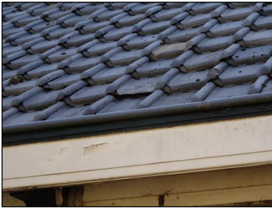
Fig. 2.25 Spleet bij dakpan, gebouw 7 (bron: FF Solutions)
