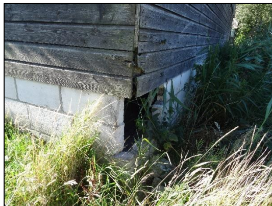
Fig. 2.4 Gat in muur van gebouw 1 (bron: FF Solutions)
