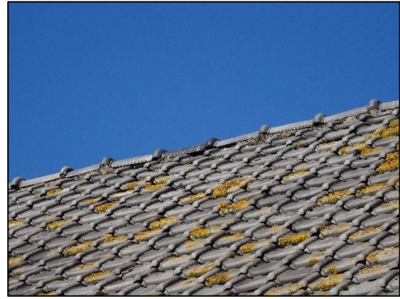
Fig. 2.26 Ontbrekend cement in nok, gebouw 7 (bron: FF Solutions)
