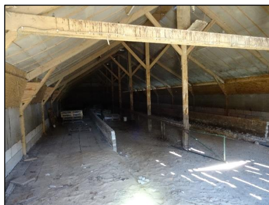
Fig. 2.8 Binnenzijde gebouw 2 (poepresten op balk zijn afkomstig van voormalig ingebruikname voor pluimvee) (bron: FF Solutions)
