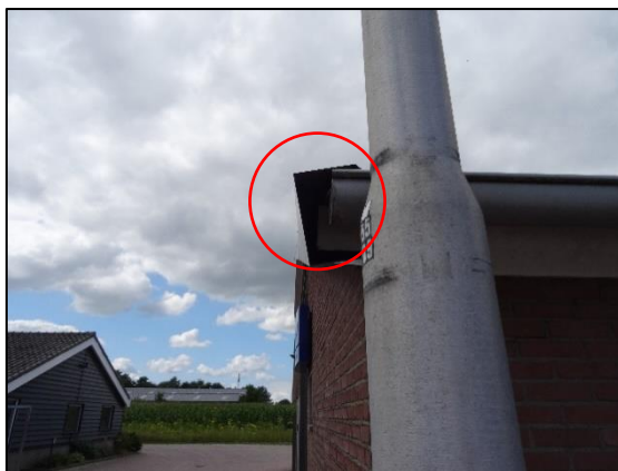
Fig. 2.39 Gat bij dakrand, gebouw 10 (bron: FF Solutions)
