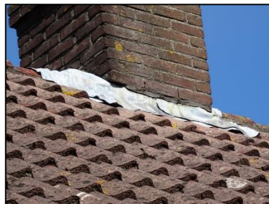
Figuur 38. Ruimte onder loodslabben rond schoorsteen woning bij Doornsteeg 8.
