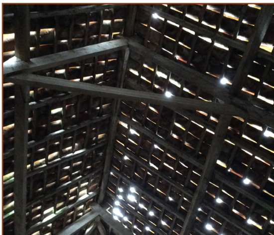
Afb. 2.4: Binnenkant dak van de monumentale schuur. Door het ontbreken van dakbeschot is de schuur ongeschikt voor vleermuizen.
