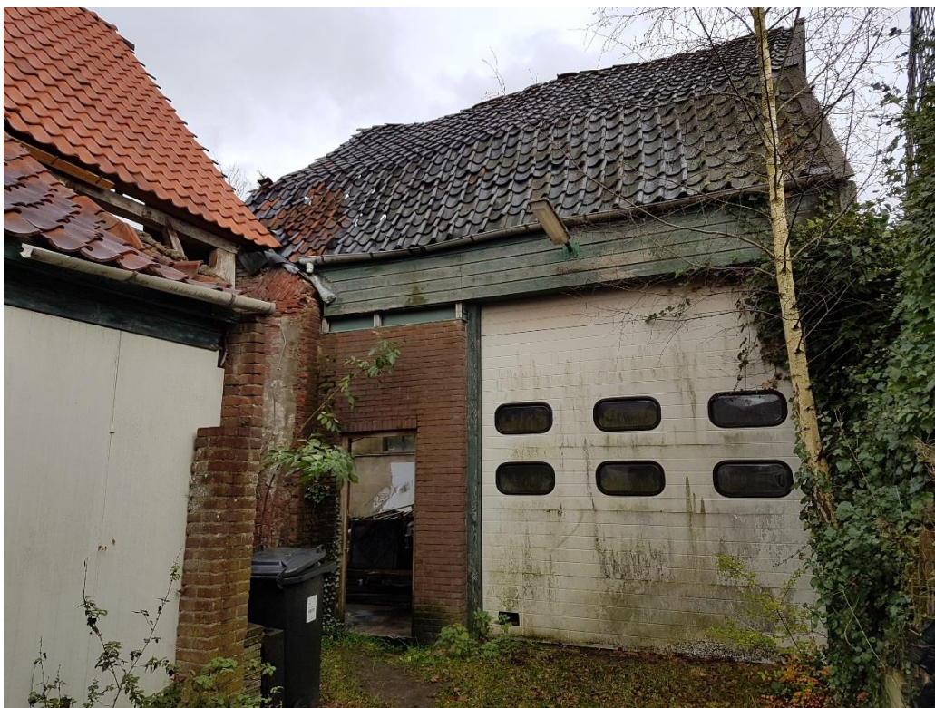
Figuur 2 De vervallen schuur aan de oostzijde van de planlocatie wordt gesaneerd.
