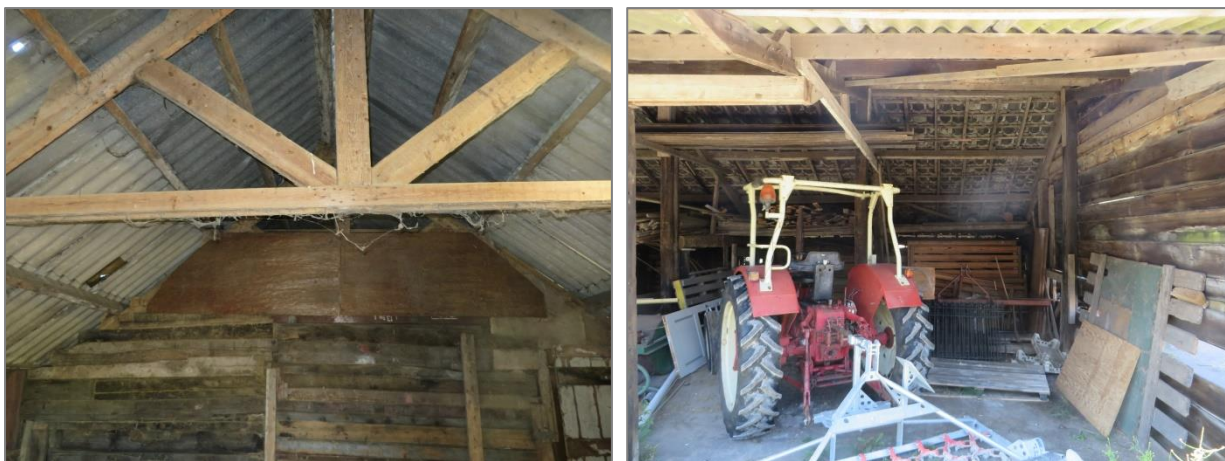
Afbeelding 5.1. Links een asbestplaten dak op één van de te slopen houten schuren, rechts een pannen- en asbestplatendak op één van de te slopen opstallen. Foto's: Natuurkompas, 2017.
