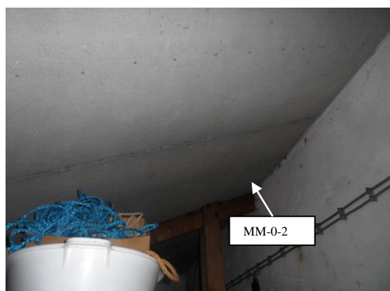
Foto 5: Asbesthoudend plaatmateriaal aan het plafond van schuur 1.
