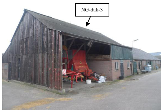
Foto 23: Geïntervieweerde schuur 5 met gedeeltelijk asbesthoudende golfplaat als dakbedekking vanuit oost-zuidoostelijke richting gezien.
