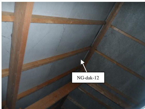
Foto 37: Asbesthoudend plaatmateriaal als dakbeschot van schuur 11.
