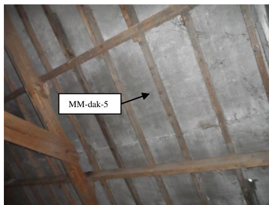
Foto 14: Asbesthoudend plaatmateriaal als dakbeschoot van schuur 3.
