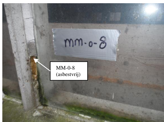
Foto 21: Asbestvrije stopverf (wit) in/aan raamkozijnen schuur 5.
