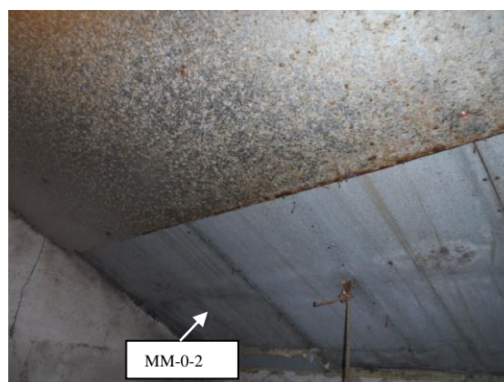
Foto 6: Asbesthoudend plaatmateriaal aan het plafond van schuur 1.
