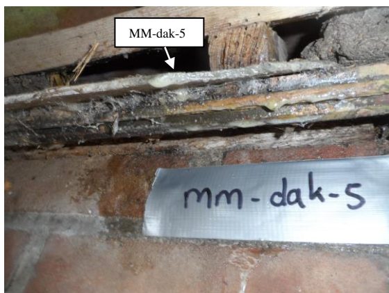
Foto 13: Asbesthoudend plaatmateriaal als dakbeschoot van schuur 3.
