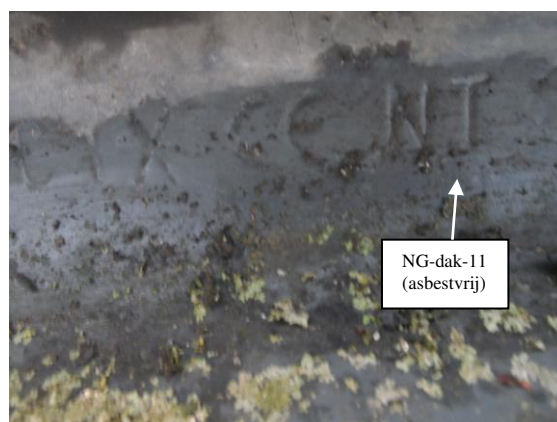
Foto 36: Asbestvrije golfplaat als dakbedekking t.p.v. klein gedeelte van schuur 10.
