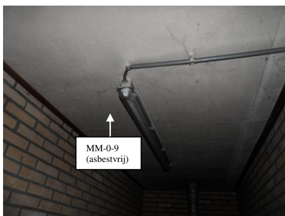
Foto 29: Asbestvrij plaatmateriaal aan plafond in schuur 7.
