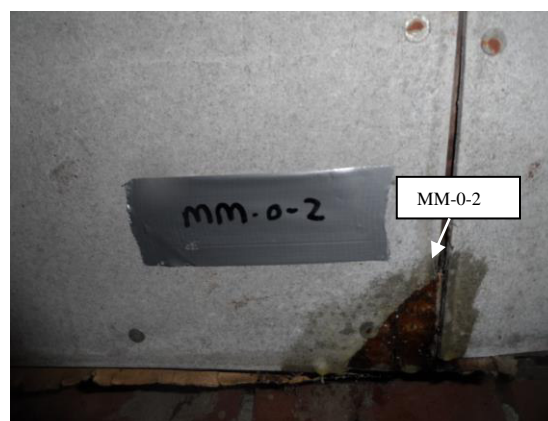
Foto 4: Asbesthoudend plaatmateriaal aan plafond in schuur 1.
