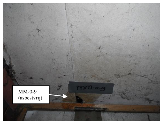
Foto 28: Asbestvrij plaatmateriaal aan plafond in schuur 7.
