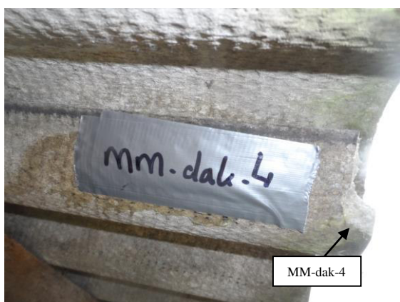
Foto 9: Asbesthoudende golfplaat als dakbedekking van schuur 2.
