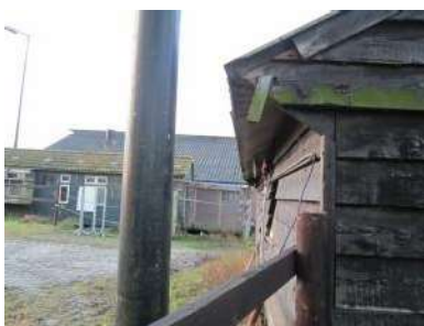
Foto 11: Asbestdak stal boven paardenpak
