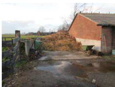
Foto 7: Zuidwestelijke stal met stortschade aan dak en achterliggende mestvang
