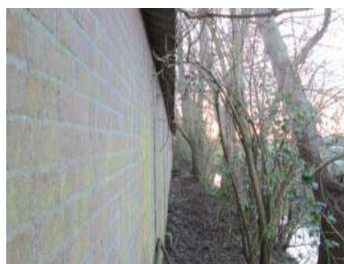
Foto 12: Onverharde strook onder asbestdak langs noordwestgrens
