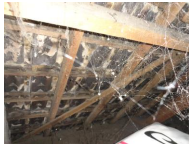
Woning, dakpannen binnenzijde
