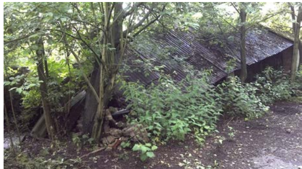
Foto 4: Ingezakte overkapping met blikken golfplaten met (links) op het maaiveld asbestverdachte golfplaten
