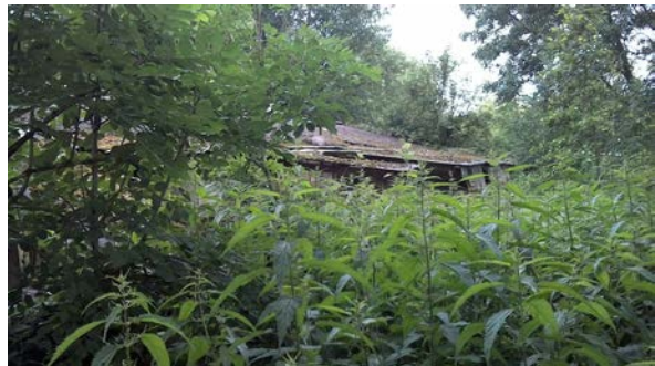
Foto 6: Deels ingezakte overkapping van voormalige kalverenschuur met begroeiing
