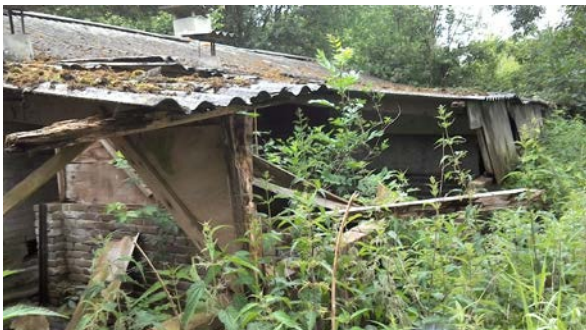
Foto 7: Deels ingezakte overkapping van voormalige kalverenschuur
