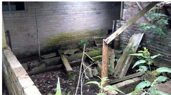
Foto 8: Asbestverdachte golfplaten in de deels ingezakte overkapping van de voormalige kalverenschuur
