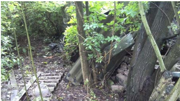
Foto 5: Detail asbestverdachte golfplaten naast de overkapping van foto 4
