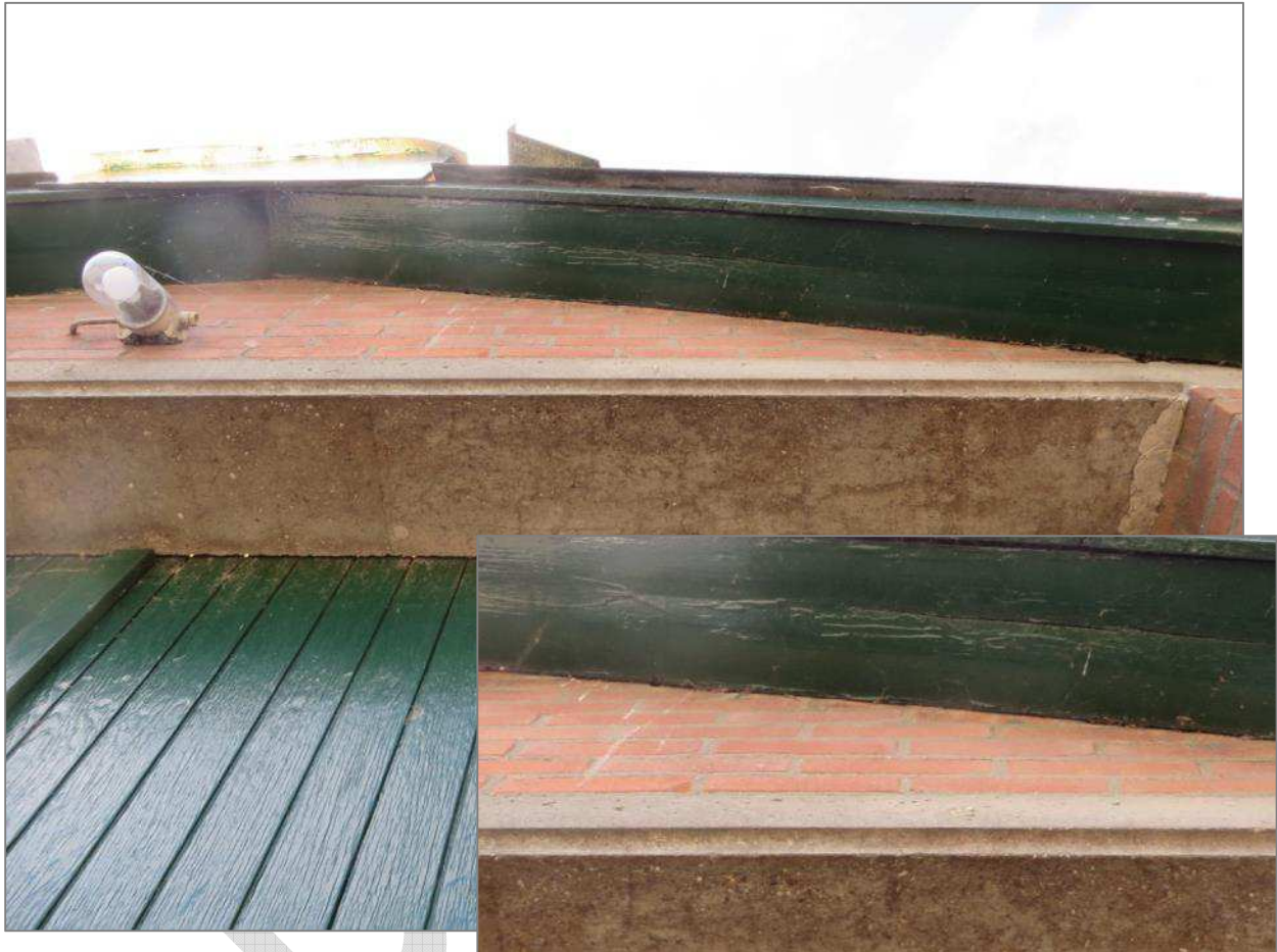
Afbeelding 5.1. Eén van de opstallen met een uitsnede van de daklijst. Duidelijk zichtbaar zijn de strepen vogelpoep op de muur en het spinrag tussen muur en houtwerk. Foto: Natuurkompas, 2015.
